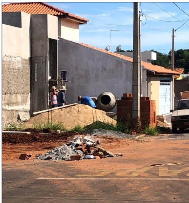
Figura 7: AUSENCIA DE TRATAMENTO PARA RESÍDUOS DA CONSTRUÇÃO CIVIL
