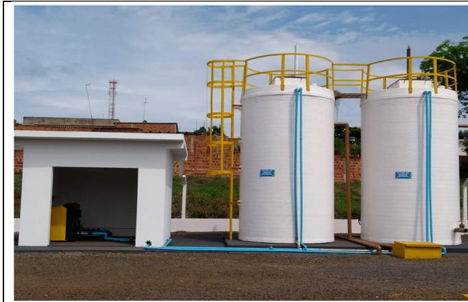
Foto 2 - Vista das instalações da ETE Santa Salete.
