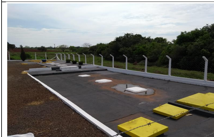
Foto 4 - Vista das instalações da ETE Santa Salete.
