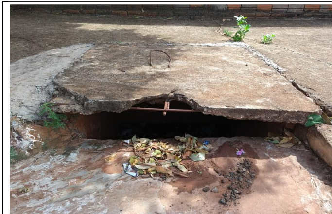
Foto 6 - Dispositivo de captação existente na Rua Ulisses Guimarães. Detalhe da tampa em concreto armado quebrada, com armadura exposta.
