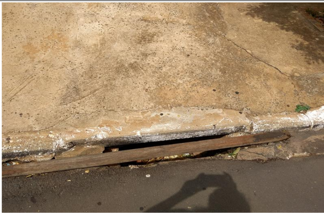
Foto 11 - Dispositivo de captação existente na Rua Ulisses Guimarães
