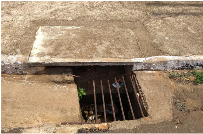
Foto 9 - Dispositivo de captação existente na Rua Ulisses Guimarães. Detalhe do gradeamento avariado e presença de detritos no interior da caixa.
