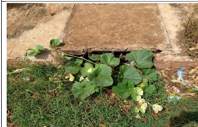
Foto 8 - Dispositivo de captação existente na Rua Ulisses Guimarães. Detalhe de vegetação existente obstruindo a entrada do dispositivo.
