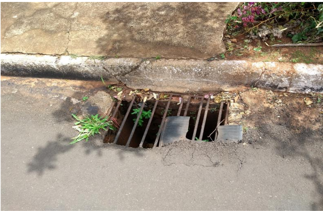
Foto 10 - Dispositivo de captação existente na Rua Ulisses Guimarães. Detalhe de gradeamento avariado.
