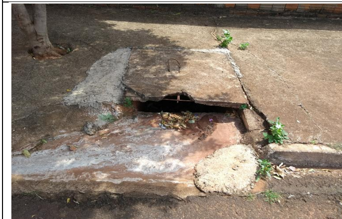
Foto 7 - Dispositivo de captação existente na Rua Ulisses Guimarães. Detalhe da tampa em concreto armado quebrada, com armadura exposta.
