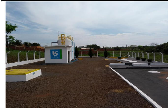
Foto 3 - Vista das instalações da ETE Santa Salete.
